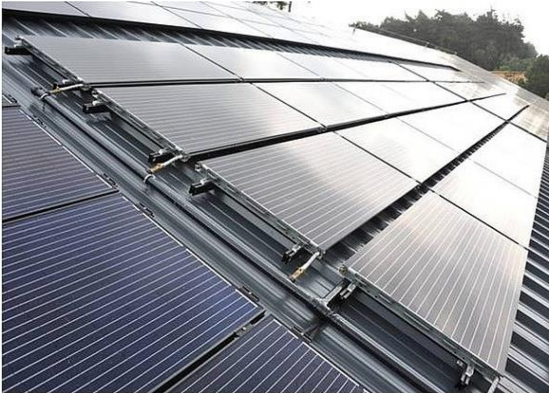
Abbildung 9.5 Hybridsonnenkollektoren auf einem Schrägdach (Quelle: Internet / www.badenova.de )
